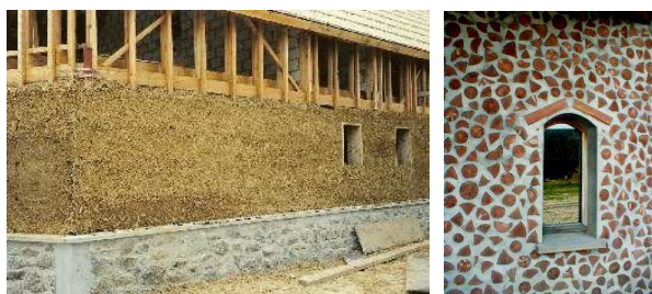
A gauche : exemple de terre-paille en cours de chantier ; à droite : exemple de bois cordé Source : www.bee.ouvaton.org et http://sinzelle.free.fr/france/saint_etienne/ferme/chevrerie.htm
